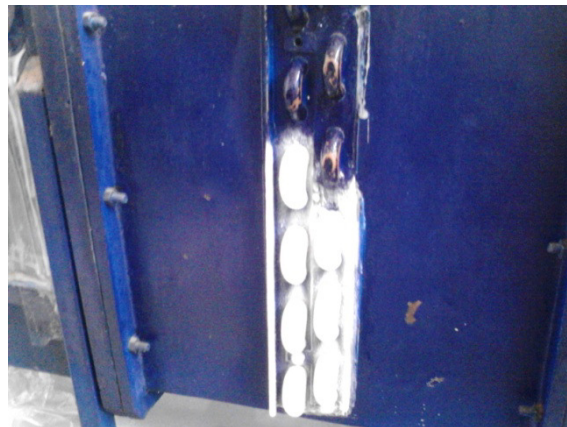
Gambar 4. Terjadi bunga es pada sisi evaporator penghambat aliran udara
