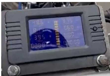
Gambar 3. Watt hour meter yang digunakan
